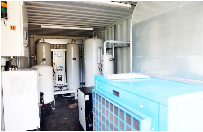
Aperçu des centrales à oxygène.
